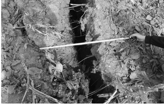
图 3 山阳中学滑坡左翼长大拉张裂缝
